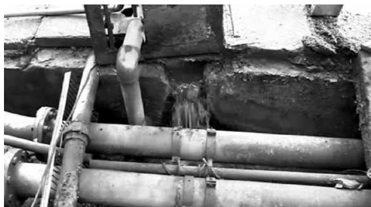
▲ Phát hiện bể thu gom nước thải chưa qua xử lý xả trực tiếp ra hệ thống thoát nước mưa
